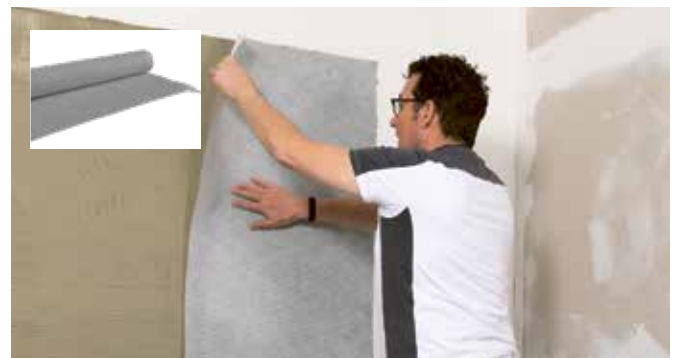
Die nicht sichtbare Flächenheizung für Wände und Decken mit ERFURT-KlimaTec FH 300 PRO
