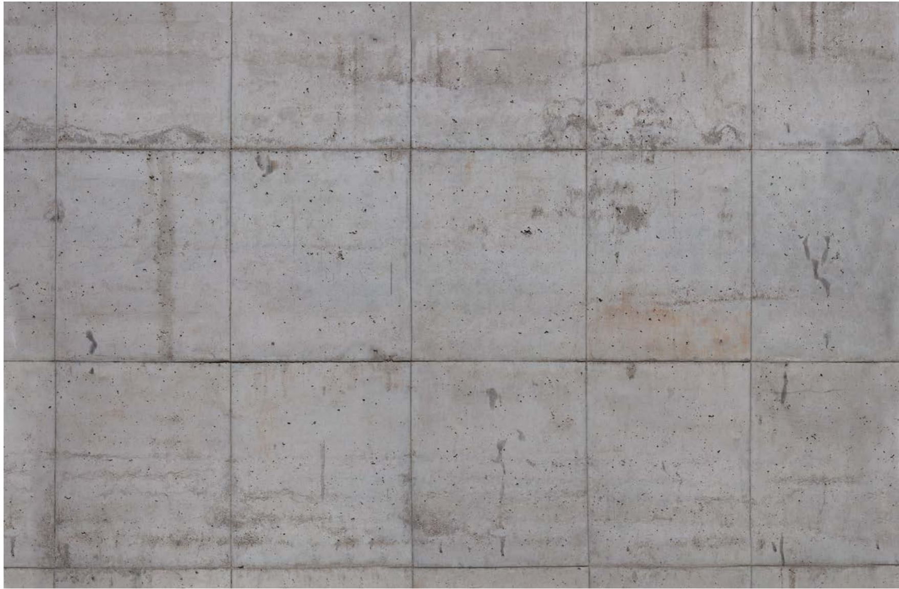
407 | CAVITÉ DANS BÉTON APPARENT
