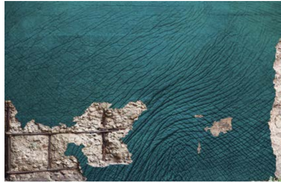
866-3 | Tuffi auf Bewehrung
