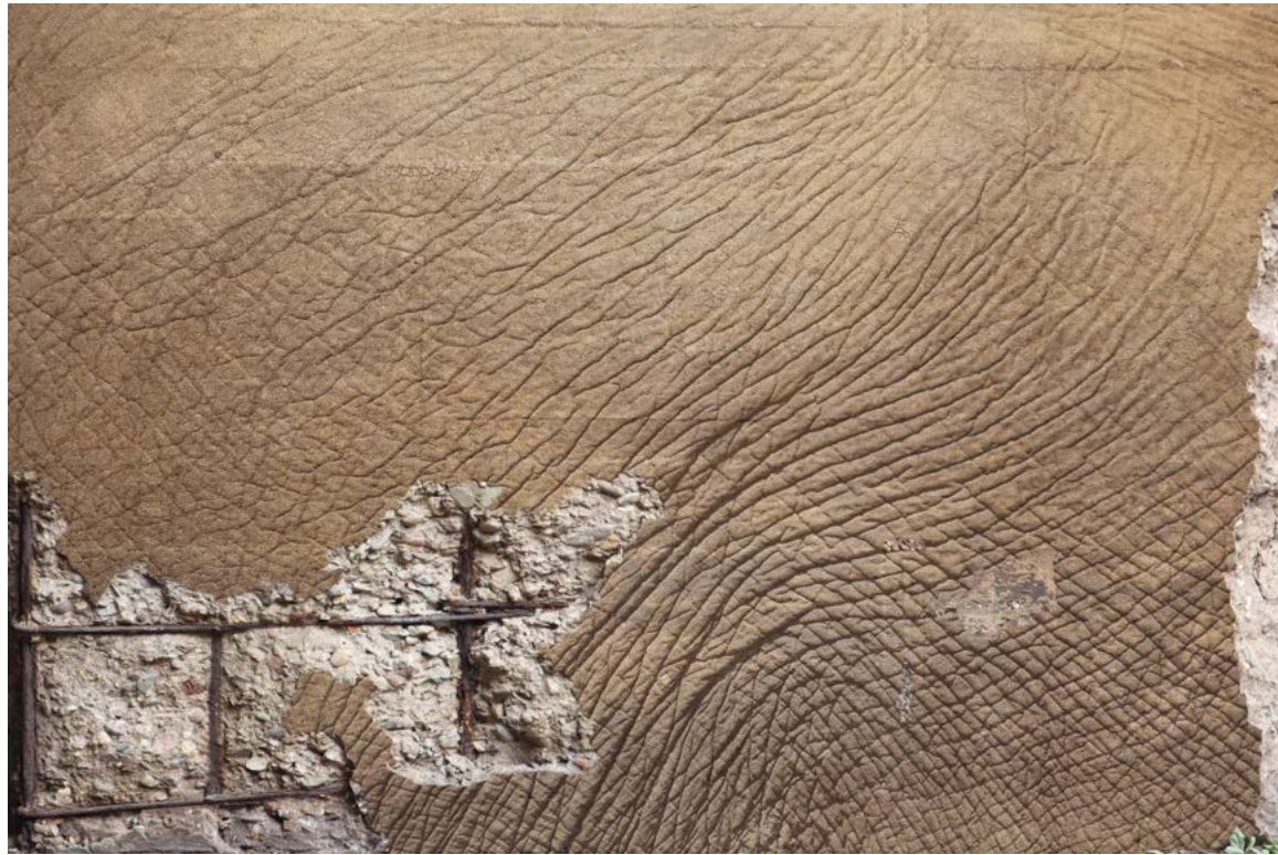
866-1 | Tuffi auf Bewehrung
