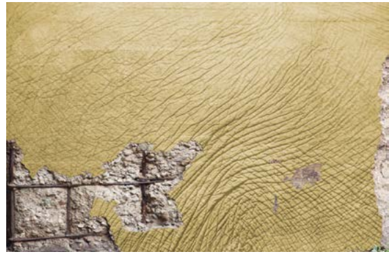
866-2 | Tuffi auf Bewehrung
